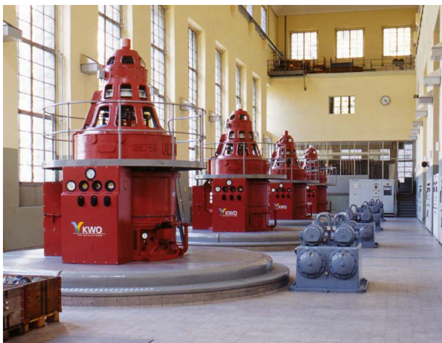
Vue dans la salle des machines de la centrale Handeck 1
