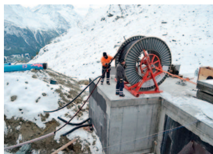
L'AAB6 sur le toit du captage d'eau
