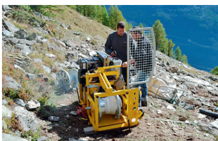
Die KZW20 ist im Lawinengang solide verankert
