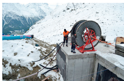
Der AAB6 auf dem Dach der Wasserfassung
